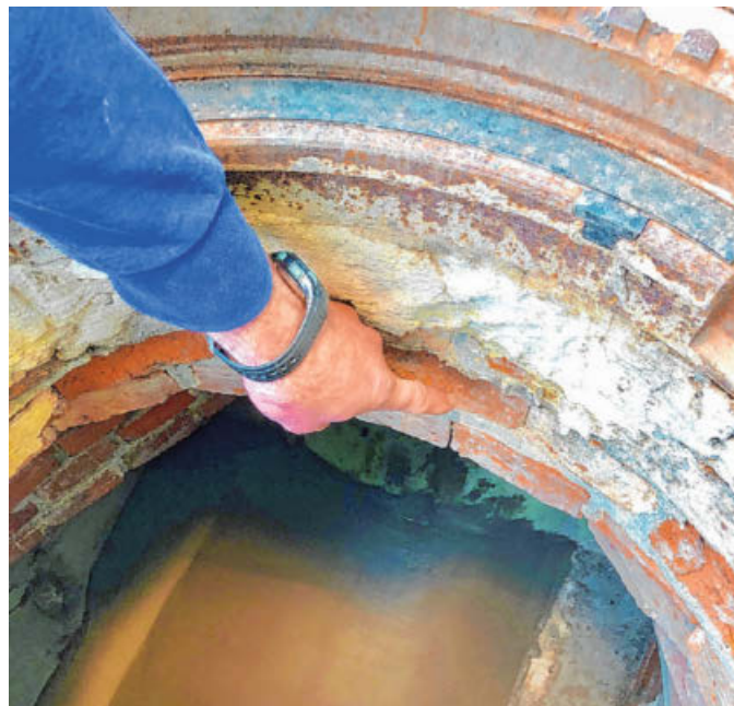
Da gibt es Schwachstellen: Einige Kanalschächte sind noch gemauert und entsprechend in die Jahre gekommen. Sie werden regelmäßig überprüft.
