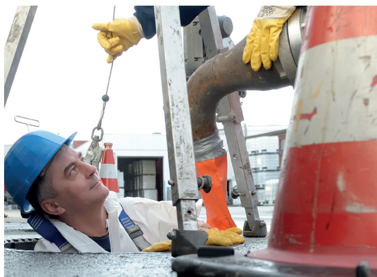
Profis am Werk: Mit ihrer Fachkompetenz ist die Rainer Kiel Kanalsanierung ein weltweit gefragter Spezialist für Arbeiten an sämtlichen Elementen des Abwassersystems.
